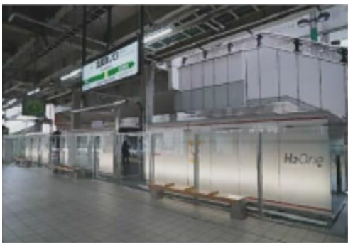
上りホーム設置エネルギー供給システム
