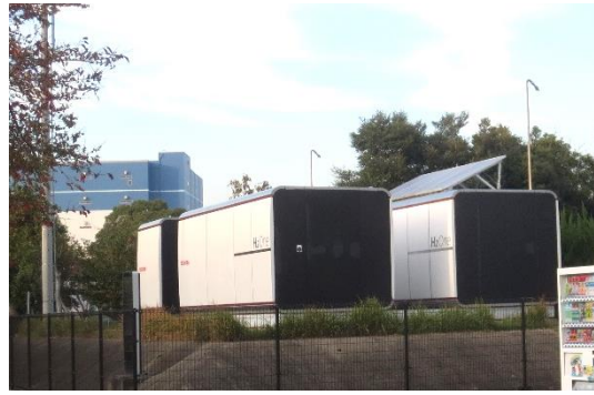
水素エネルギーメインコンテナ
