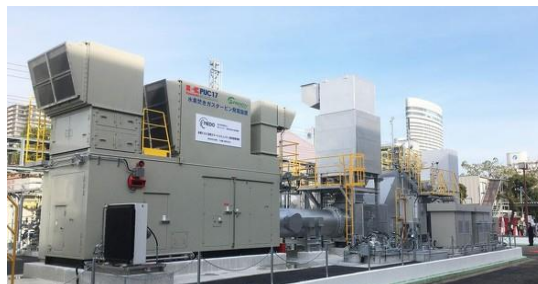
ドライ低 NOx 水素専焼タービン実証プラント 出典：大林組
