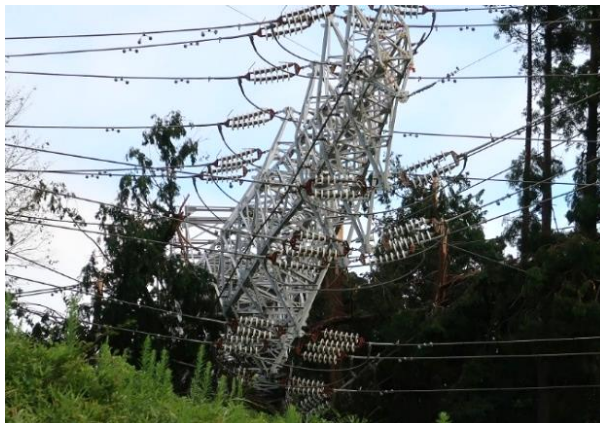
超大型台風により鉄塔が倒壊する被害
