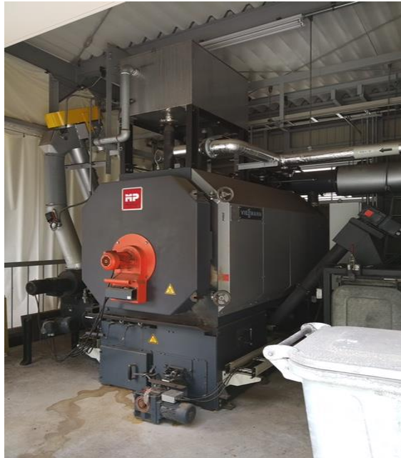
ボイラー燃料は竹チップ
