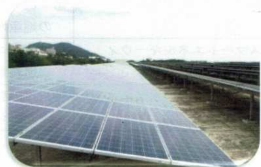
施設屋上に設置された太陽光パネル
