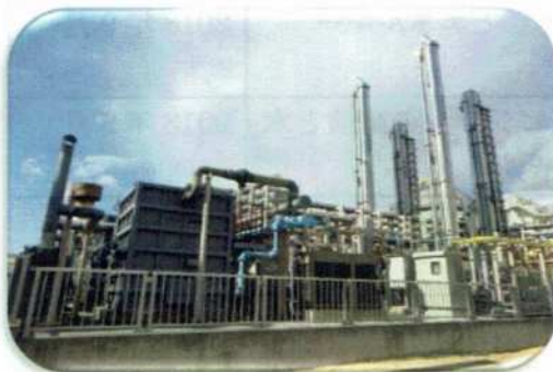
消化ガス精製装置 出典：日経 BP
