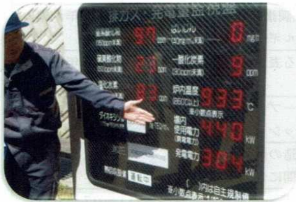
発電量などを表示するパネル
