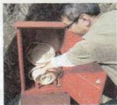
花山台消火栓と消火器具庫
