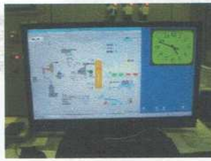
監視制御装置
