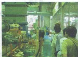
タービン発電機
