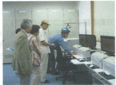
監視制御装置
