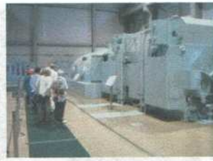
蒸気タービン・発電機
